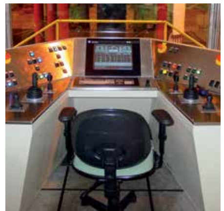
Hier zu sehen ist das Steuerpult einer 30 MN Freiformschmiedepresse in Brasilien.
