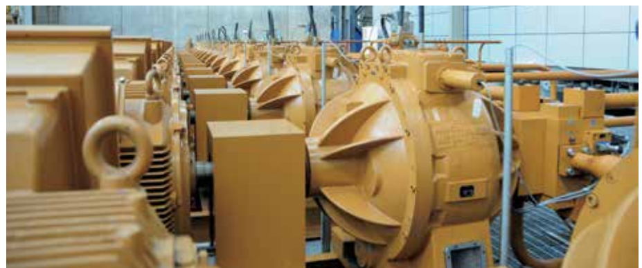
16-Pumpen-PMSD-Antrieb (RX 500) einer 80/100 MN Presse.
