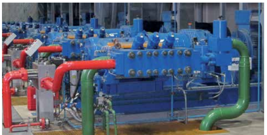
Dieser wasserhydraulische Pressenantrieb von Wepuko PAHNKE ist bei OFAR in Italien im Dienst.
