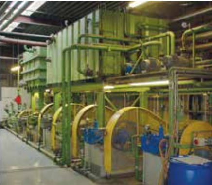
Pumpenaggregate in einer Druckwasseranlage.
