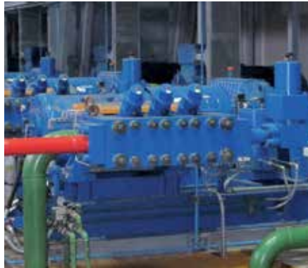
Mehrere Plungerpumpen für den Antrieb einer Freiformschmiedepresse.
